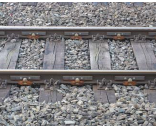
Schienendämpfer der Firma Schrey & Veit, Stadtbahn Berlin, Fern- und S-Bahngleise Nähe Haltepunkt Savignyplatz
