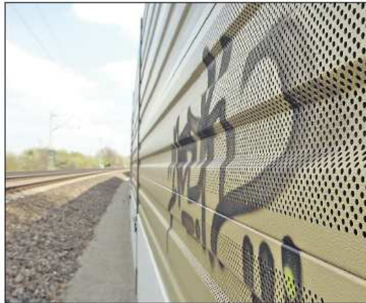
Wieviel Lärmschutz zahlt die Bahn? Noch ist das nicht abschließend geklärt.
