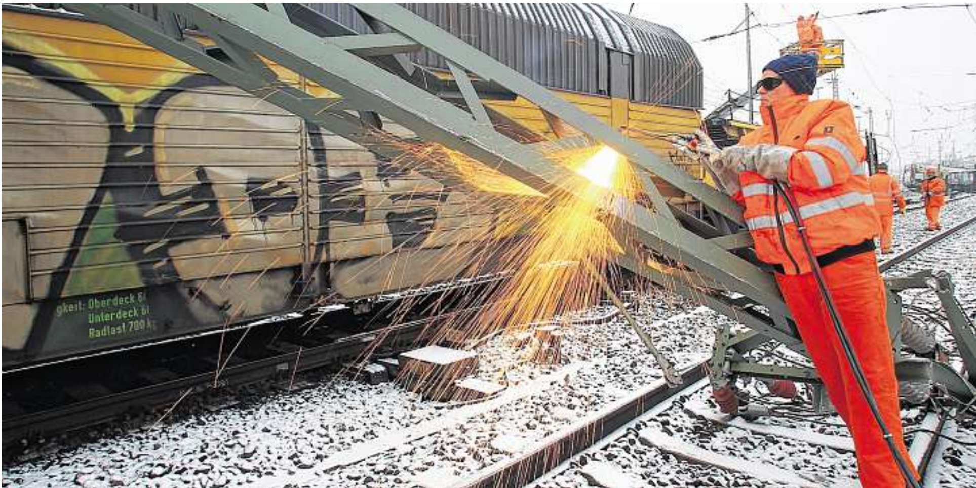
Ein Mitarbeiter der Deutschen Bahn schweißt den abgerissenen Stahlmast auseinander, der auf einem der Waggons gelandet war.
