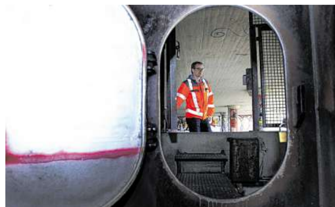
Einstieg in den Hohlkasten der Brücke: Heiner Apel öffnet die Luke für Mitarbeiter der Stadtwerke und Ingenieure.
